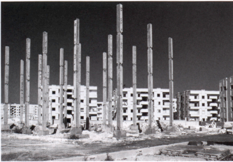
Links: Staatliche Wohnsiedlung für Militärangehörige in Fertigteilbauweise in Al Hamadania, Aleppo. Foto: Stefanie Bürkle
